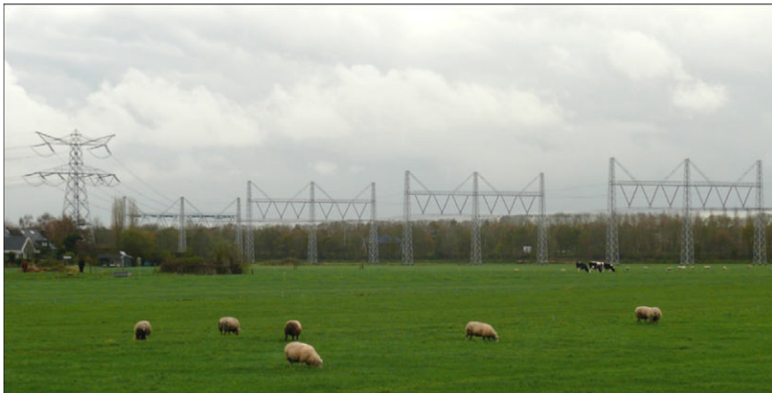
Figure 7. Une ligne de 380 kV sur laquelle les câbles conducteurs sont abaissés et suspendus à des portiques en un seul plan horizontal pour réduire les risques de collision des Grands Cormorans ( Phalacrocorax carbo ), des Spatules blanches ( Platalea leucorodia ) et des Hérons pourprés ( Ardea purpurea ) qui survolent quotidiennement ce tronçon de ligne situé entre leurs colonies et leurs zones d'alimentation, Muiden, Pays-Bas (Photo: Bureau Waardenburg).
