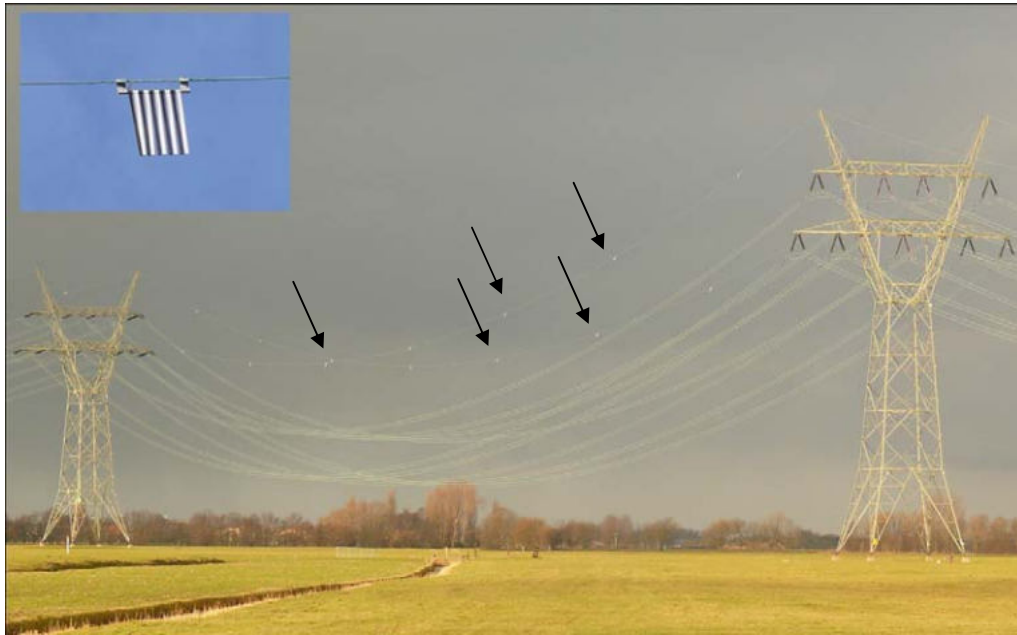
Figure 12. Ligne à haute tension (150 kV) aux Pays-Bas équipée de balises ou « bird flappers » (voir encadré et flèches) placées à intervalles réguliers sur les deux câbles de garde (Photo: Bureau Waardenburg).
